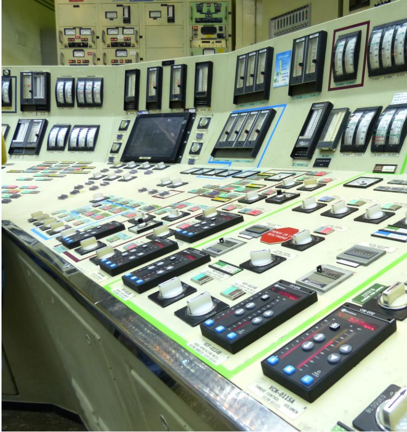
Componentes del nuevo sistema de control digital del reactor en la sala de control.
