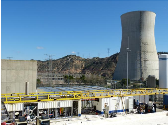
Montaje de la planta instalada para la limpieza química de los generadores de vapor.
